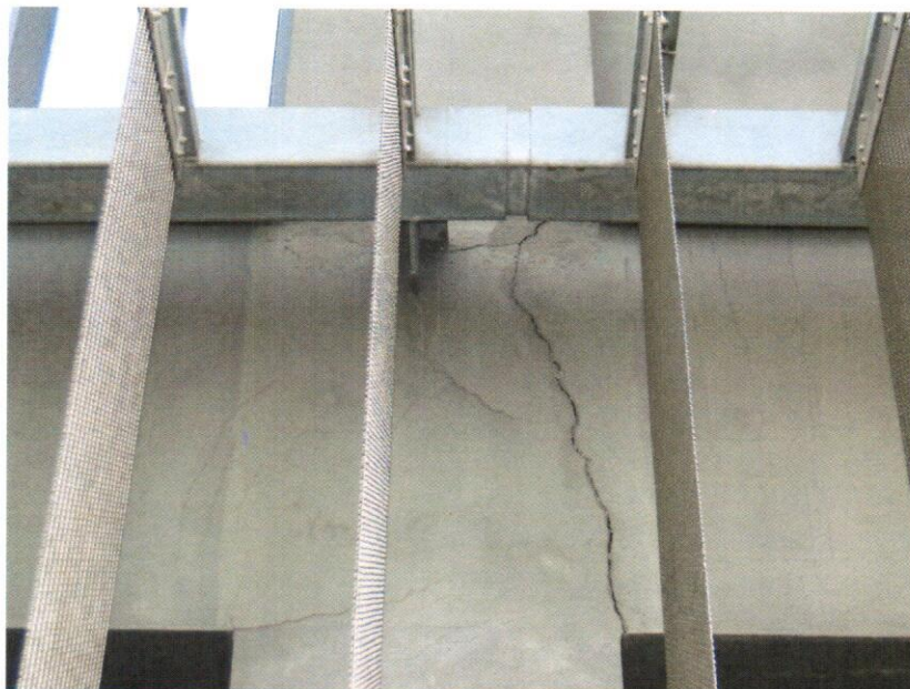
Zdjęcie nr 2: Przykładowe pęknięcia na elewacji w osi 4 budynku, spowodowane brakiem dylatacji.
