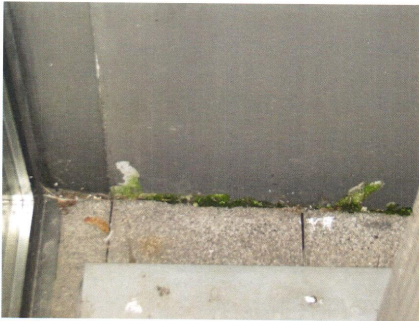
Zdjęcie nr 8: Uszkodzenia tynku na w strefie cokołowej.
