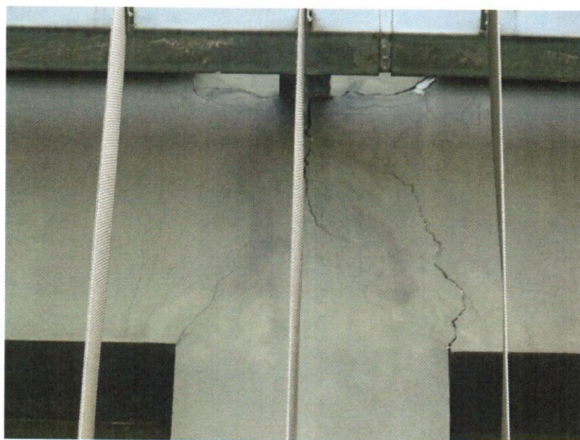
Zdjęcie nr 3: Przykładowe pęknięcia na elewacji w osi 4 budynku, spowodowane brakiem dylatacji.
