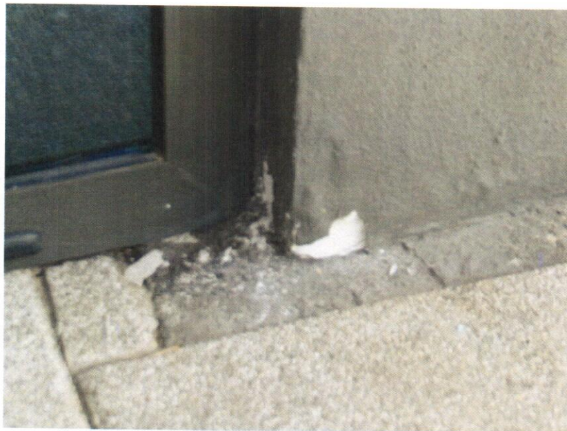
Zdjęcie nr 9: Uszkodzenia tynku na w strefie cokołowej.
