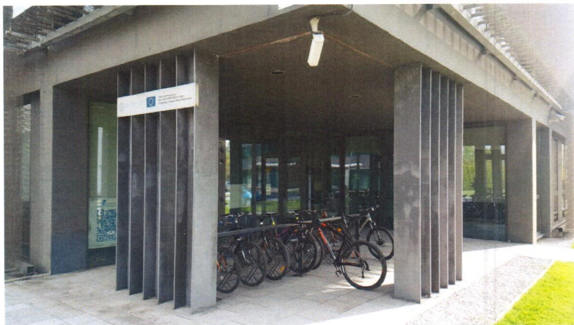
Zdjęcie nr 1: Słupy stalowe do renowacji powłok malarskich.
