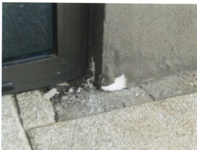
Zdjęcie nr 9: Uszkodzenia tynku na w strefie cokołowej.
