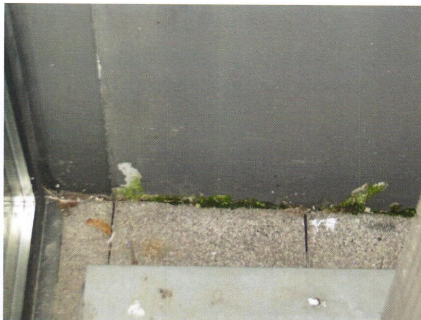
Zdjęcie nr 8: Uszkodzenia tynku na w strefie cokołowej.
